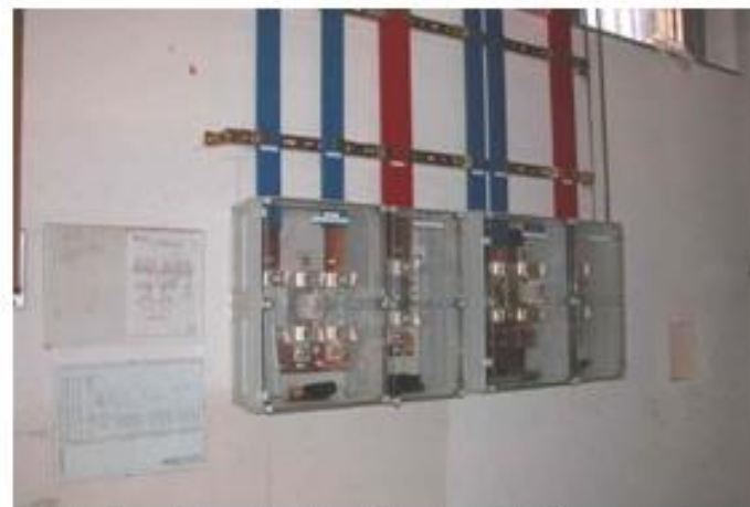
Quadro elettrico distribuzione C.C.
