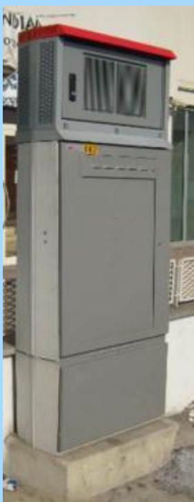
Sopralzo 48 porte VDSL2 installato su armadio stradale
